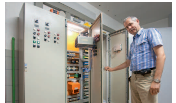
Benno Hofmann, Wassermeister der Stadtwerke und Garant für die gute Qualität des Hanauer Trinkwassers
