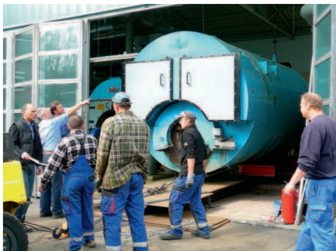
Überflüssig: Durch die Fernwärmeleitung konnte Heraeus seinen alten ölbetriebenen Heizkessel ausrangieren
