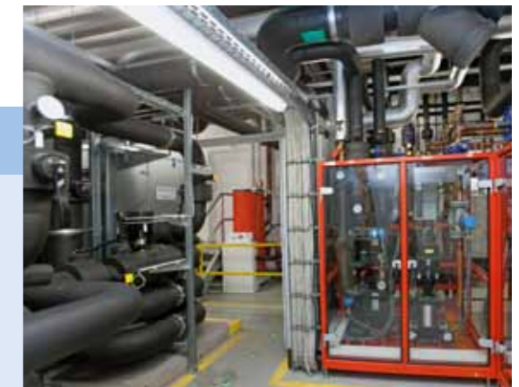
Blick hinter die Kulissen: Über Steuerungskästen gelangt die Abwärme in den schwarzen Rohren zu den Wärmetauschern.
