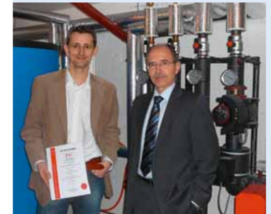
Angeschlossen: Kai Hagenkötter von der Hausverwaltung Hagenkötter (links) und SWH-Geschäftsführer Hans-Rüdiger Wiedem vor einer der neuen Fernwärme-Übergabestationen im Salisweg
