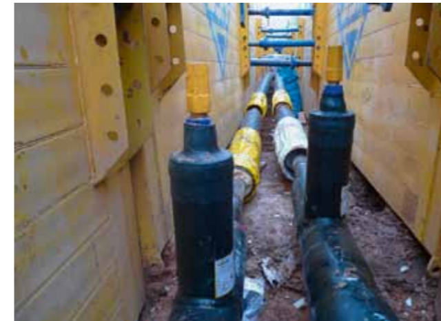
Kontinuierlich erweitern die Stadtwerke Hanau ihr Fernwärmenetz.
